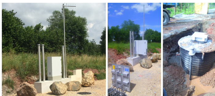
Vue d'ensemble de l'installation
